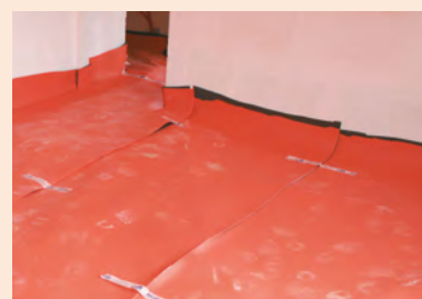
Opheffen van \pm 15 \text{ cm} tegen de muren voor de chape uit te voeren
